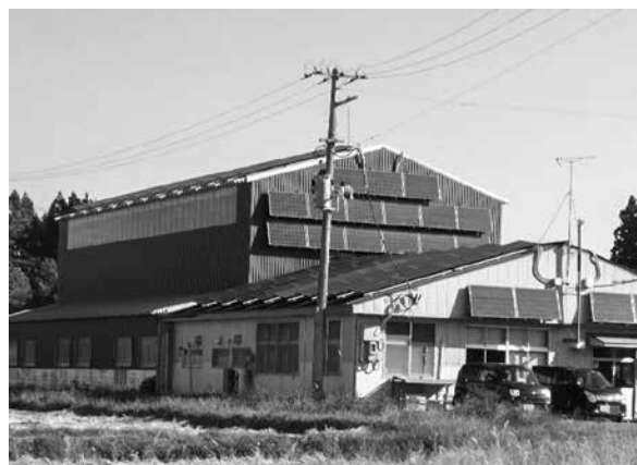
屋根や壁に設置された太陽光発電
