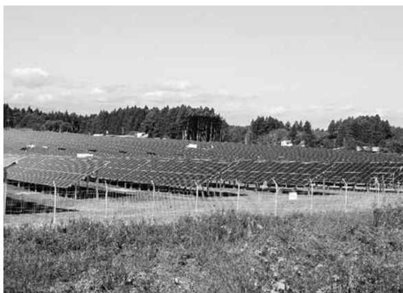
少し広い場所には、規模の大きめな発電設備が
