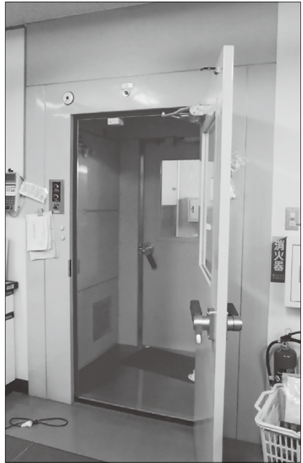
二重扉のクリーンルーム(当所微生物室内)
